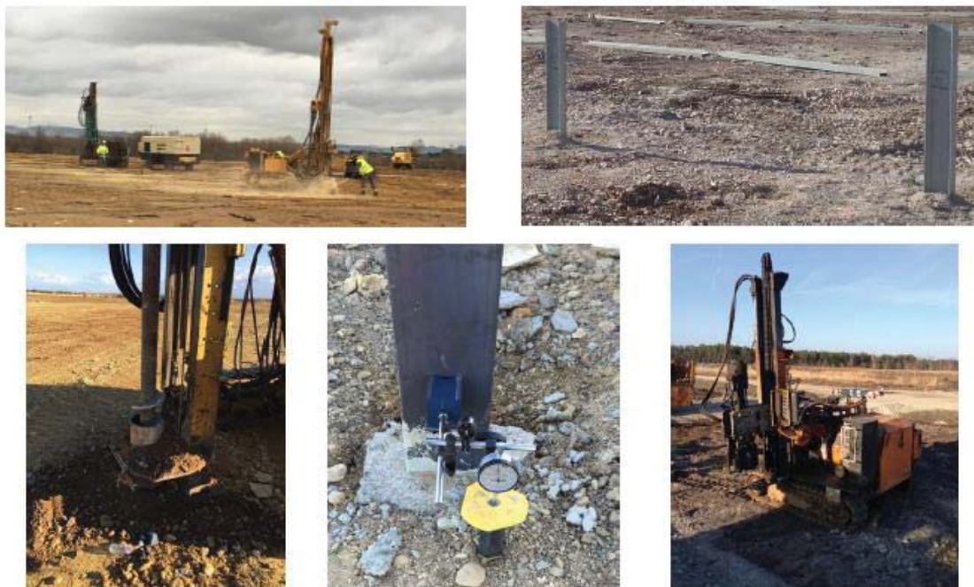
Photos d'illustration du mode d'ancrage des structures photovoltaïques
